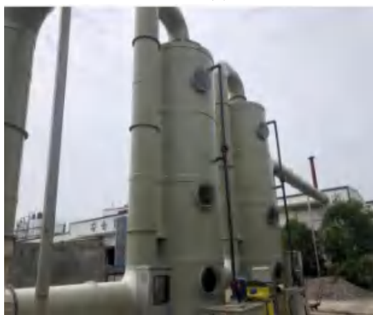
车间前喷淋塔
