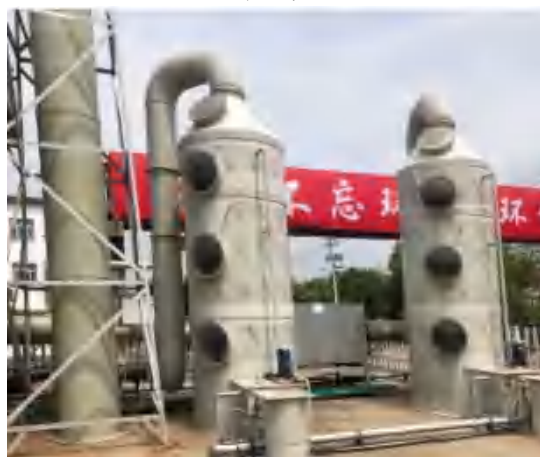
污水处理站旁喷淋塔
